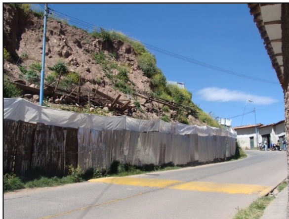
ESTADO DE CONSERVACION SECTOR 1 EN MAL ESTADO: SE PRESENTO UN DESLIZAMIENTO Y POCO INTERVENCION PARA LA CONTENCIÓN DE ESTA
