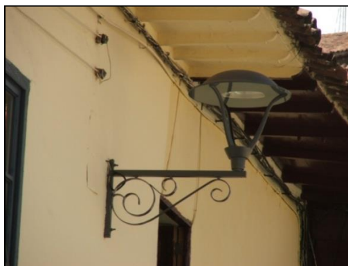
ILUMINACIÓN EN MUROS: PASTORAL
