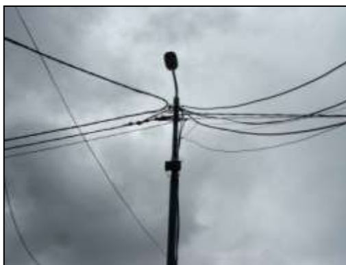
POSTE DE ALUMBRADO PUBLICO
