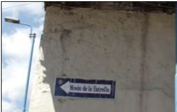
SEÑALIZACIÓN DE CIRCULACIÓN EN MURO(ESQUINA CON TRES CRUCES)
