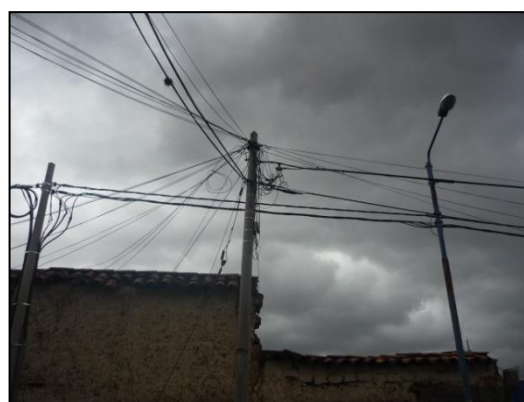
POSTE DE ILUMINACION Y POSTE DE RED ELECTRICA
