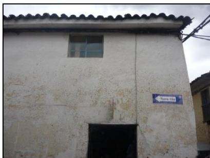
SEÑALIZACION DE CIRCULACION DE UN SOLO SENTIDO EN MURO
