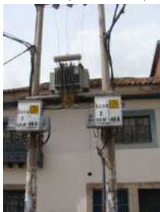
POSTES DE SOPORTE DE CABLEADO CON TRANSFORMADOR ELÉCTRICO.
