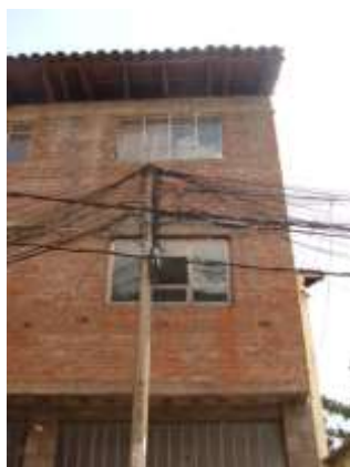
POSTES DE SOPORTE DE CABLEADO AÉREO.
