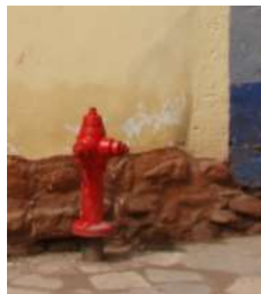
GRIFO CONTRA INCENDIOS.
