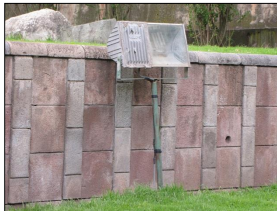
LUMINARIA EN POSTE METALICO BAJO.
