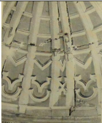
Agrietamiento de la cúpula después del sismo.
